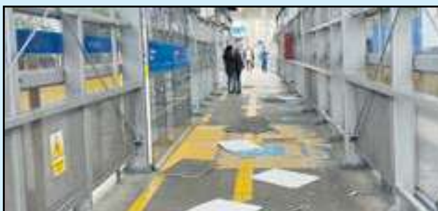
También cayó parte del techo de la Estación Balta de El Metropolitano en Barranco
