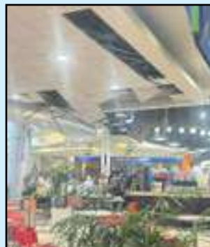
Parte del techo de Plaza Norte colapsó tras el fuerte remezón
